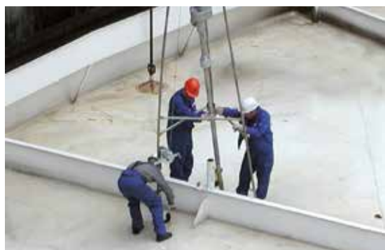
Так называемые Jet-Washer форсунки опускаются внутрь резервуара по специальным вертикальным трубам
